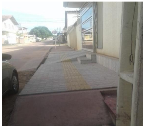
Figura 7: Irregularidade na construção de calçadas normatizadas.
