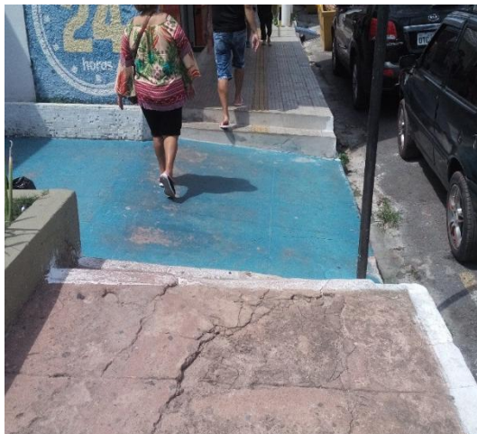
Figura 15: Deterioração de calçadas, Centro de Santarém.
