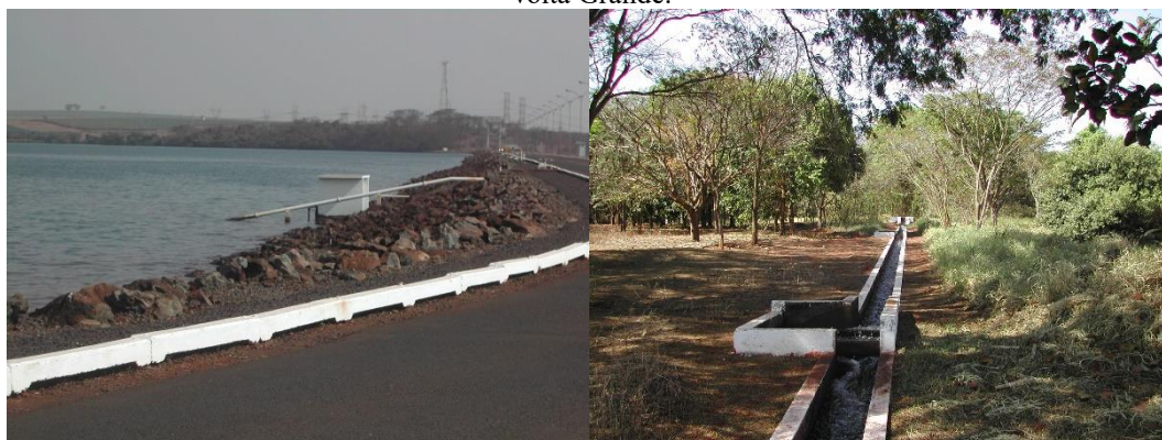
Figura 2. Vista parcial da captação de água da Estação de Pesquisa e Desenvolvimento Ambiental de Volta Grande/CEMIG a esquerda e, a direita, rede de distribuição e abastecimento proveniente do Reservatório da UHE de Volta Grande.
